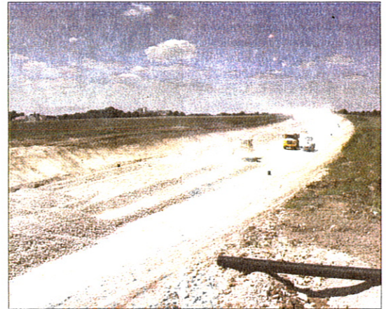
En attendant l'ouverture de l'enquête publique, un site Internet fait le point sur l'avancement du projet d'aménagement de la RN 154.
